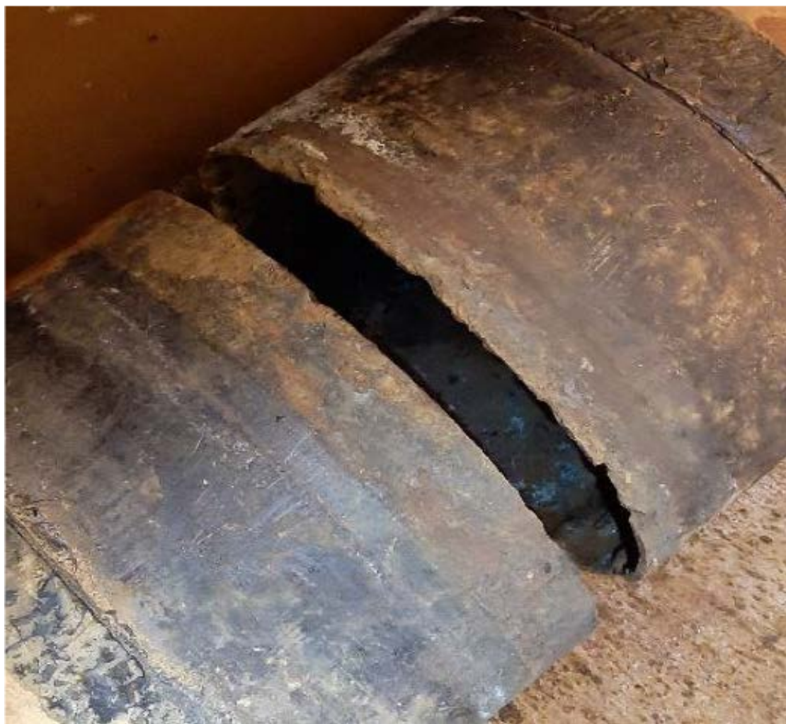
图|主管上环切一道缝隙，用于回收清扫废渣
